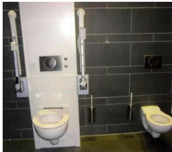
Figura 11- Servicio higiénico en la Estación Central de Berlín (Alemania).
