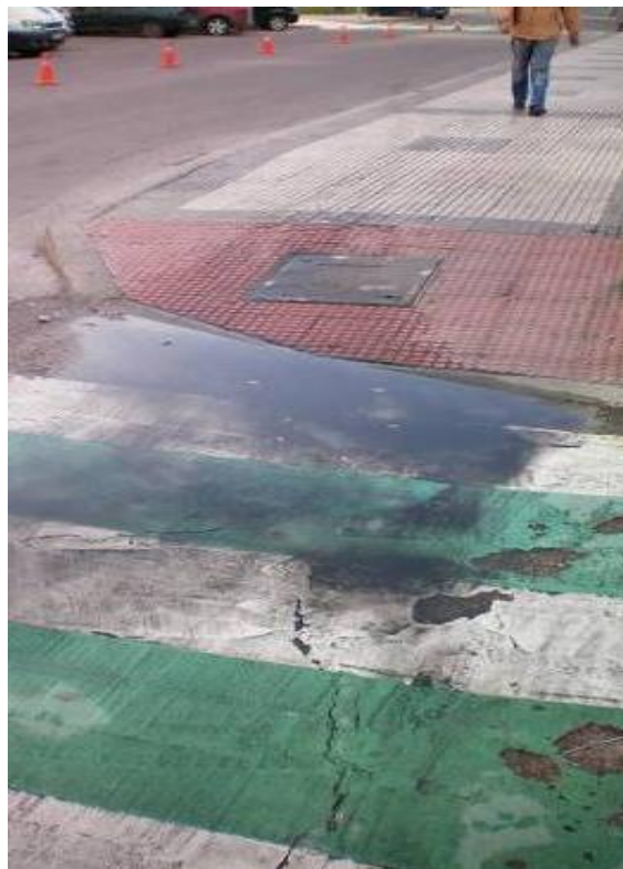
Figura XX- Mala ejecución del paso de peatones, al no prever de forma adecuada la evacuación de las aguas de escorrentía
