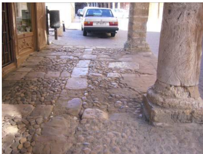
Figura xx- Pavimento irregular mediante losas y china lavada, contraindicado con relación a la accesibilidad.
